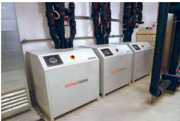
Ogrevanje in hlajenje proizvodnih in pisarniških prostorov
